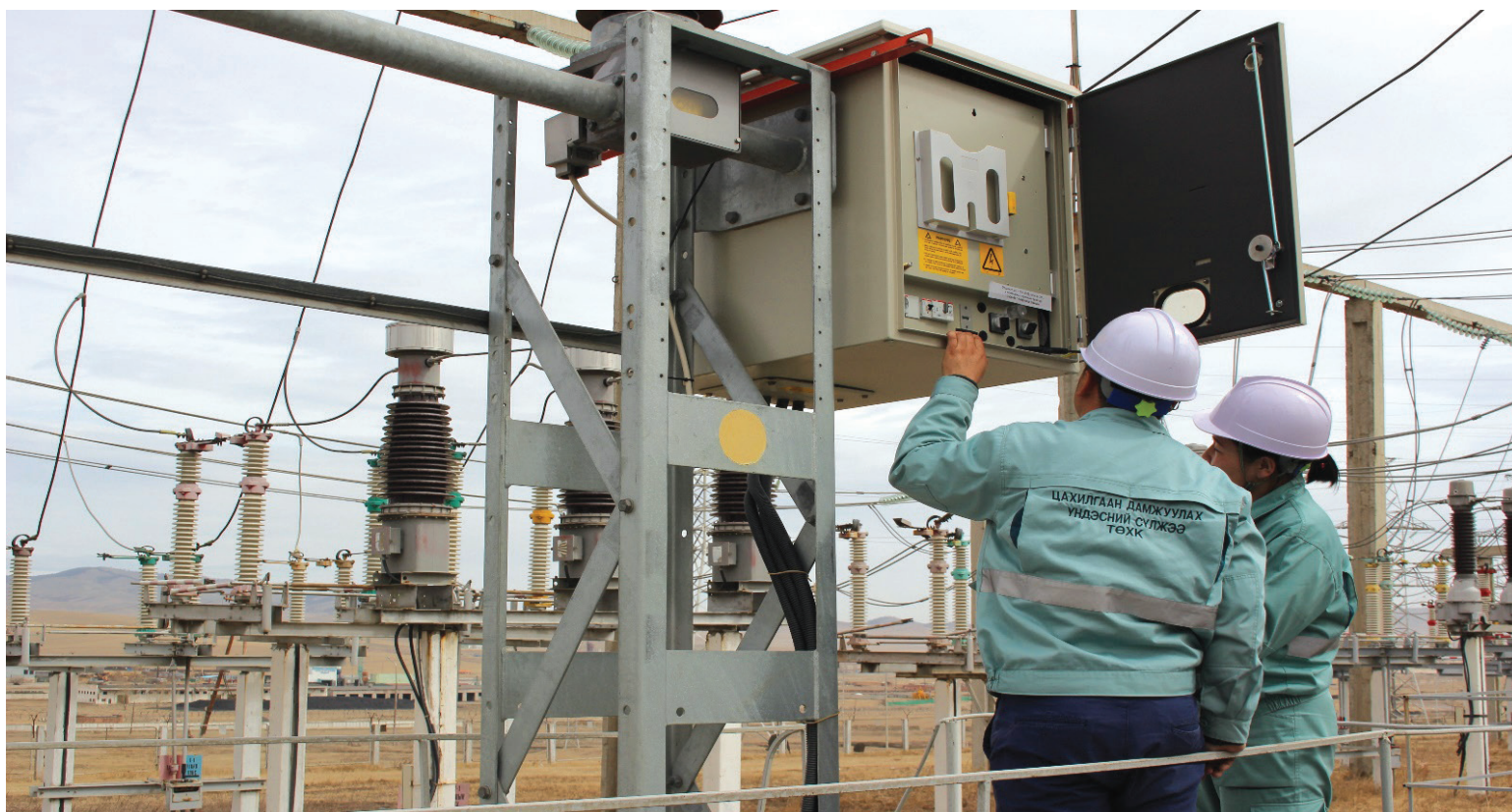
Эрдэнэт дэд станц 110 кВ-ын Булган-Б агаарын шугамын ЭТ-ийн приводны горимын түлхүүр “LOCAL” байрлалд байсан гэмтлийг хайж олж байгаа байдал
