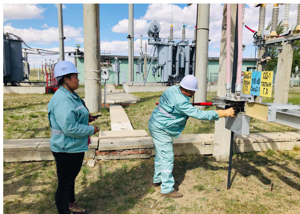
Хот дэд станцад ачаалал шилжүүлэх сэлгэн залгалт хийж байгаа нь
