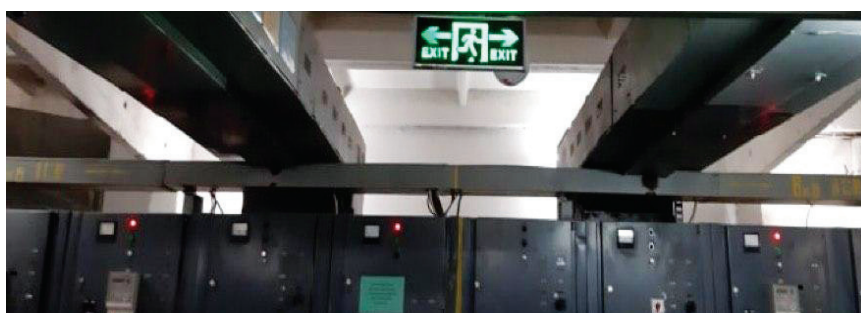
6 кВ-ын хаалттай хуваарилах байгууламжид гарах гарцын чиглэл заасан “EXIT” гэрэлт тэмдэглэгээ суурилуулж, аваарын тэжээлд холбосон байдал
