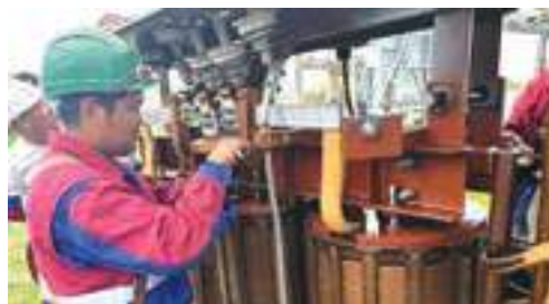
Улаанбаатар дэд станц ДХТ-1, 2
